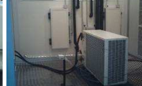
Cellule essai – pompe à chaleur
