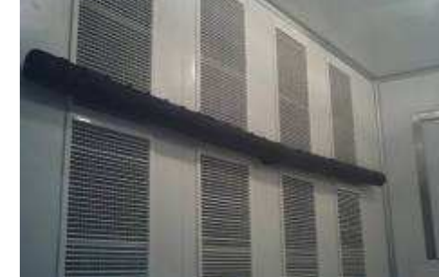
Rampe humidification – soufflage
